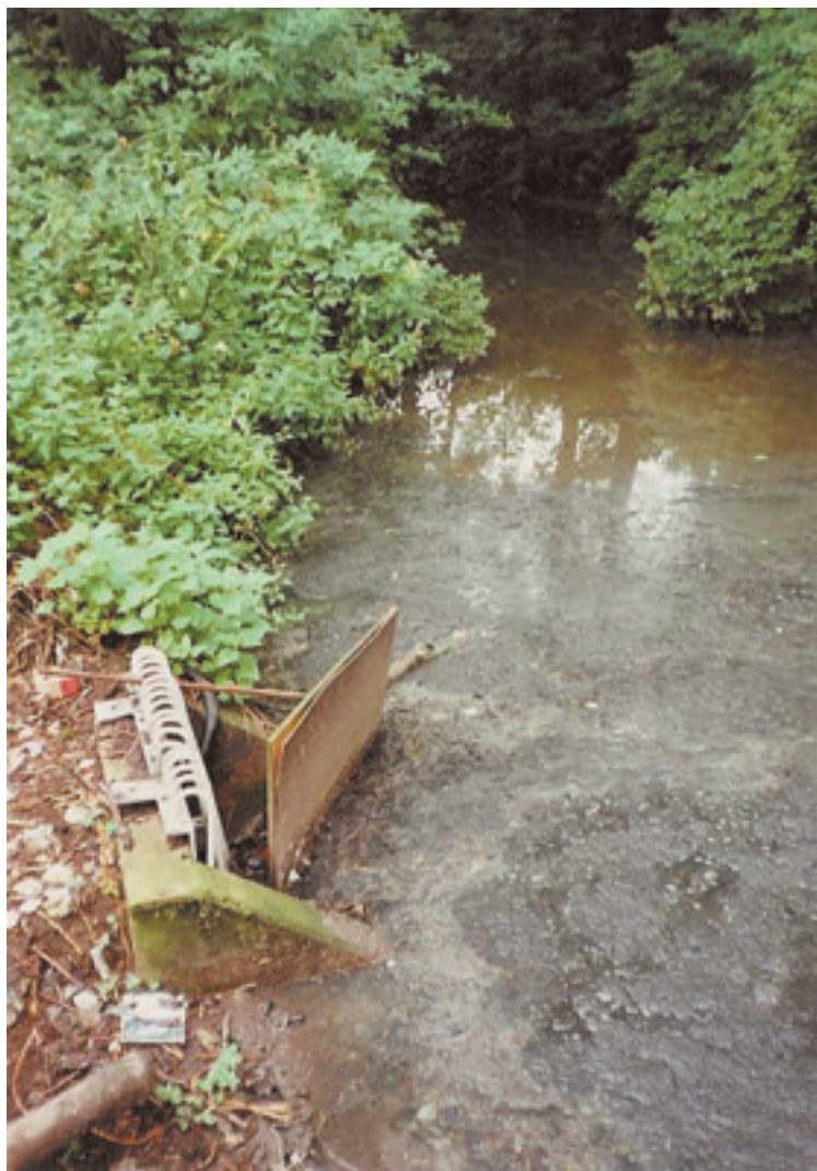
..... Figuur 2 Zichtbaar vervuilde overstortlocatie
