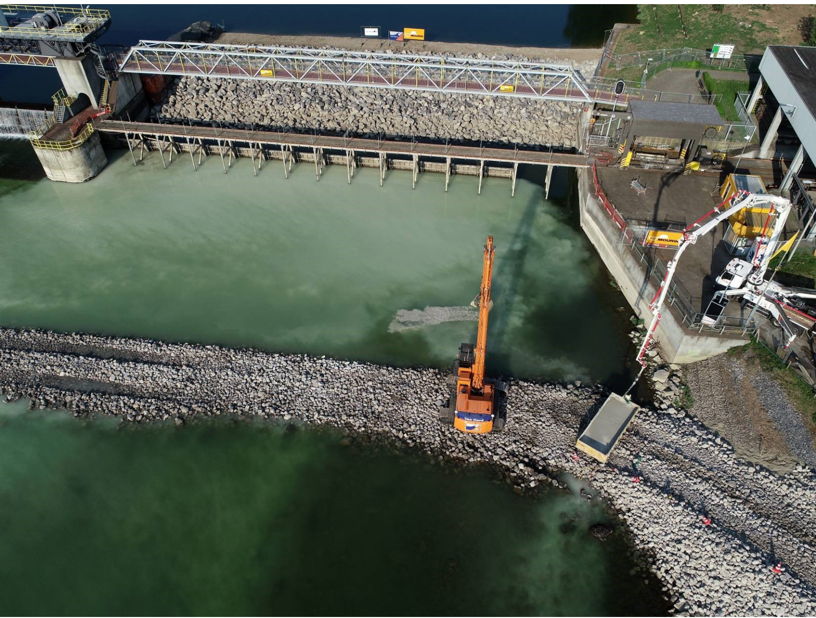
Foto: herstelwerkzaamheden stuw Linne na aanvaring met duwbakken (Bron: RWS Droneteam)
