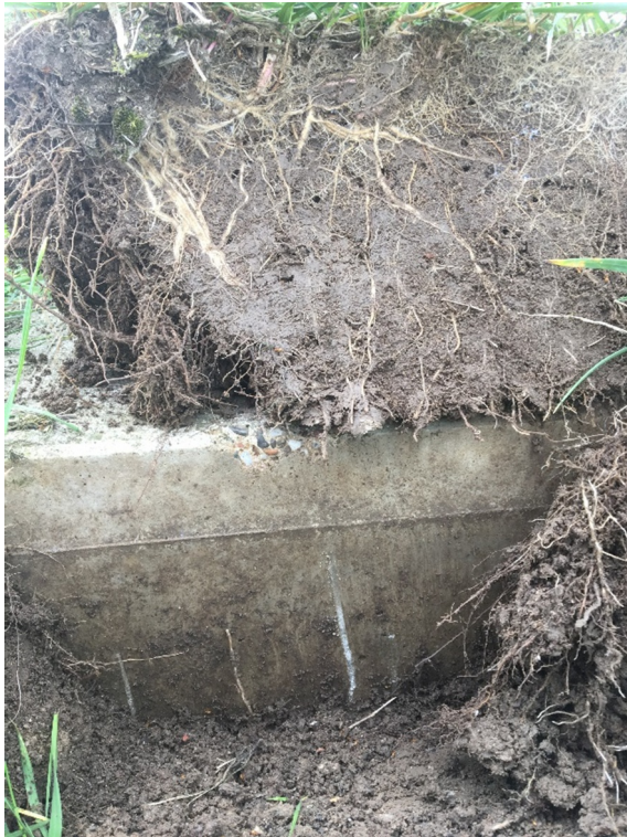
Figuur 4.1 Nette aansluiting wortelnet van de grasbekleding op de overgang, aangetoond door het steken van een plag
