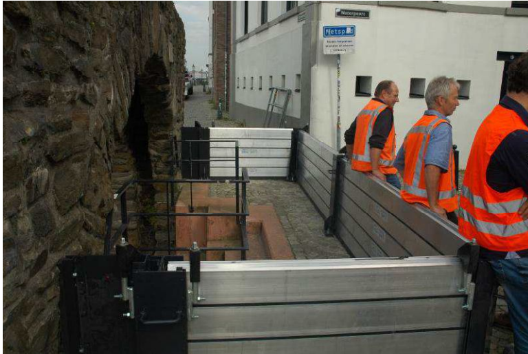
Figuur 2 U-knik in de wand ter plaatse van de Waterpoort. De hoekstaanders zijn afwijkend en er zijn een tweetal eindschotten te zien
