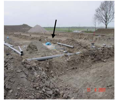
Foto 3: centrale opslag voor perssap
